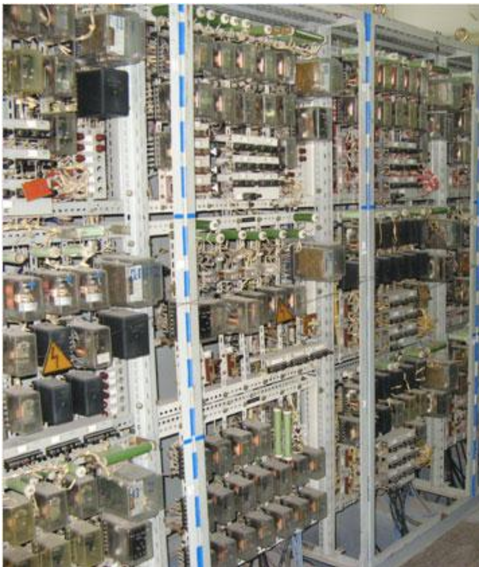
Фотография шкафа релейной защиты действующей тяговой подстанции
